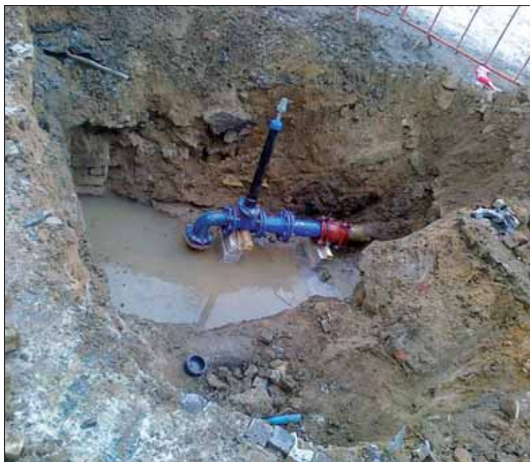
▲ Slepé rameno mezi ulicemi Patočkova a Střešovická, které pravděpodobně zavinilo kontaminaci vody.
