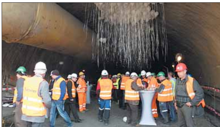
Snímek z dob zahájení stavby. Nikdo tehdy nepředpokládal, že by se dokončení mohlo opozdit o několik let. Foto: Roman Kelbich
